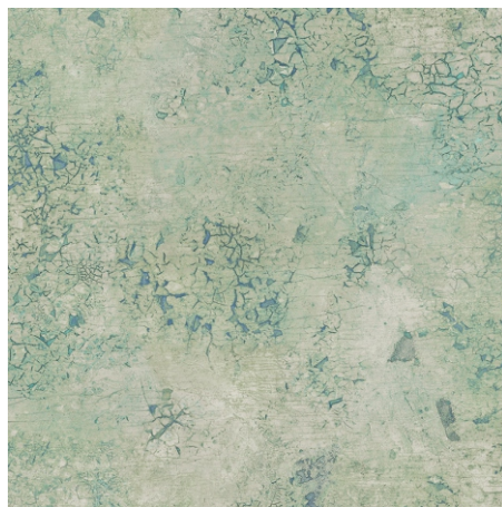
Cracked stucco Потрескавшаяся штукатурка
